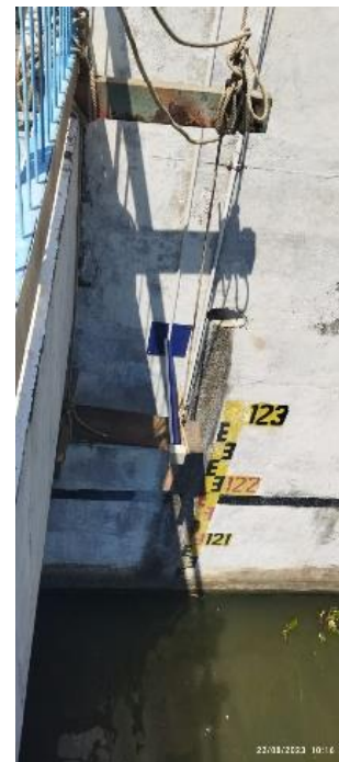
Gambar 7. Sensor ultrasonik yang terpasang pada bendungan
