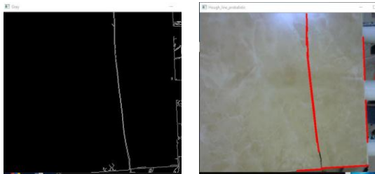
Gambar 4. Keramik retak pada bagian tengah
