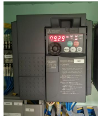
Gambar 3. Pengaturan Frekuensi Menggunakan VFD
